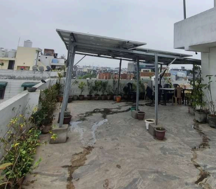
5kw Solar Project (Rohini)
